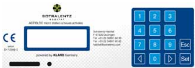
Panneau de commande de la micro-station ACTIBLOC®.
